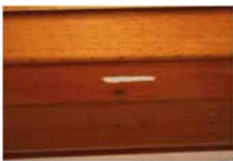
Der Riss ist lokalisiert
