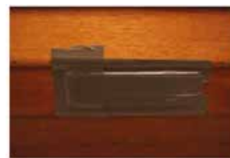
Von innen wird der Riss gleichermaßen mit Gewebepapier zugeklebt.
