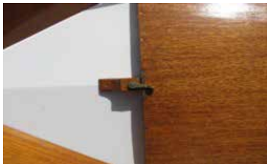
Der alte Flügelbeschlag muss nachgespannt werden. Diese sind oft zu lose.
